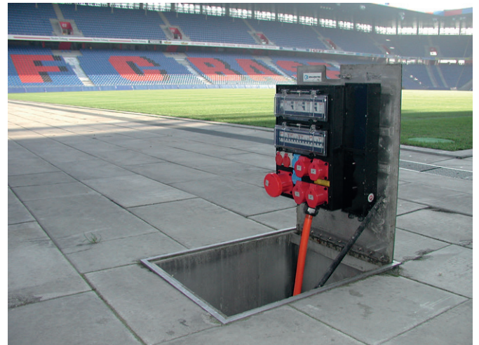
Unterflurelekrant, St.Jakob-Park Basel
