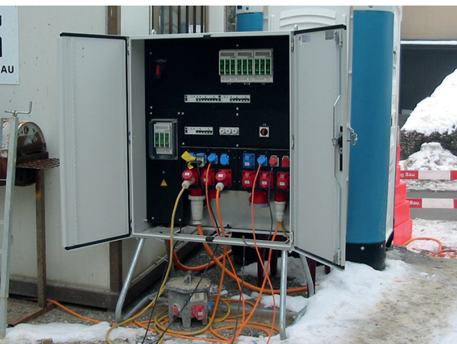
Hauptverteiler auf der Baustelle
